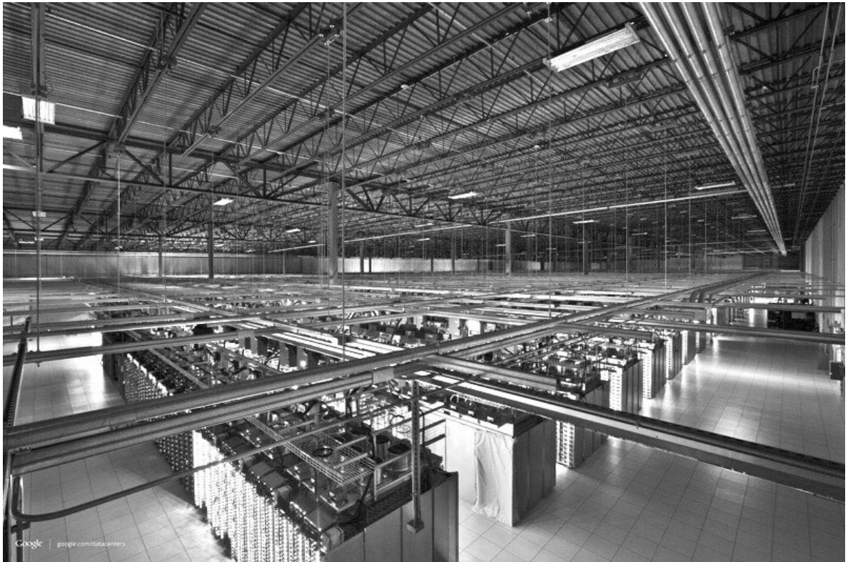
Figure 1.4 Des containers dans un centre de donnée Google
